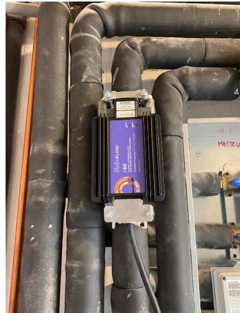
Figura 3 Hydroflow I60 - Acqua calda sanitaria
