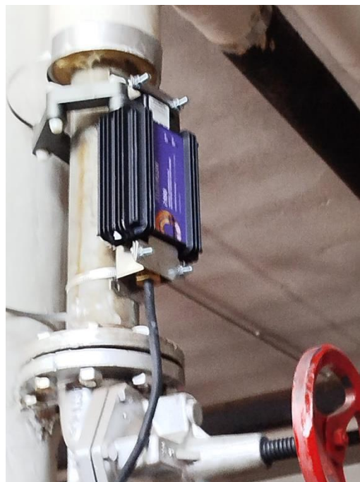
Figura 3: HydroFLOW I100 - Acqua calda sanitaria
