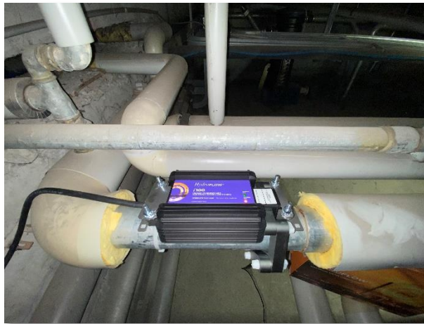
Figura 4 Hydroflow I100 – Acqua calda sanitaria
