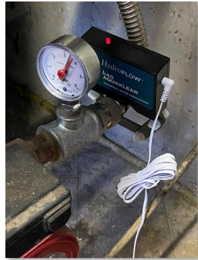
Figura 3 Hydroflow K40 – Ricircolo boiler/scambiatore
