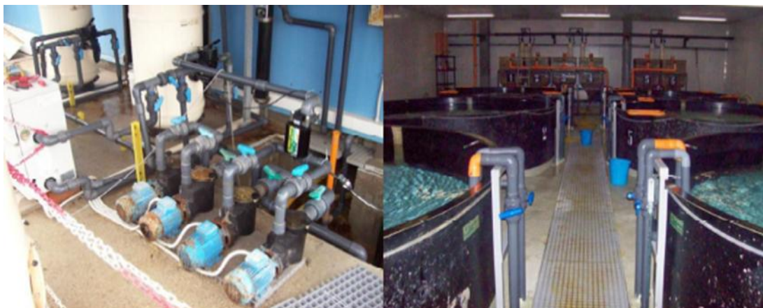
Fig. 4: la batteria di pompe con HYDROPATH installato (sinistra) e le vasche di incubazione (destra)
