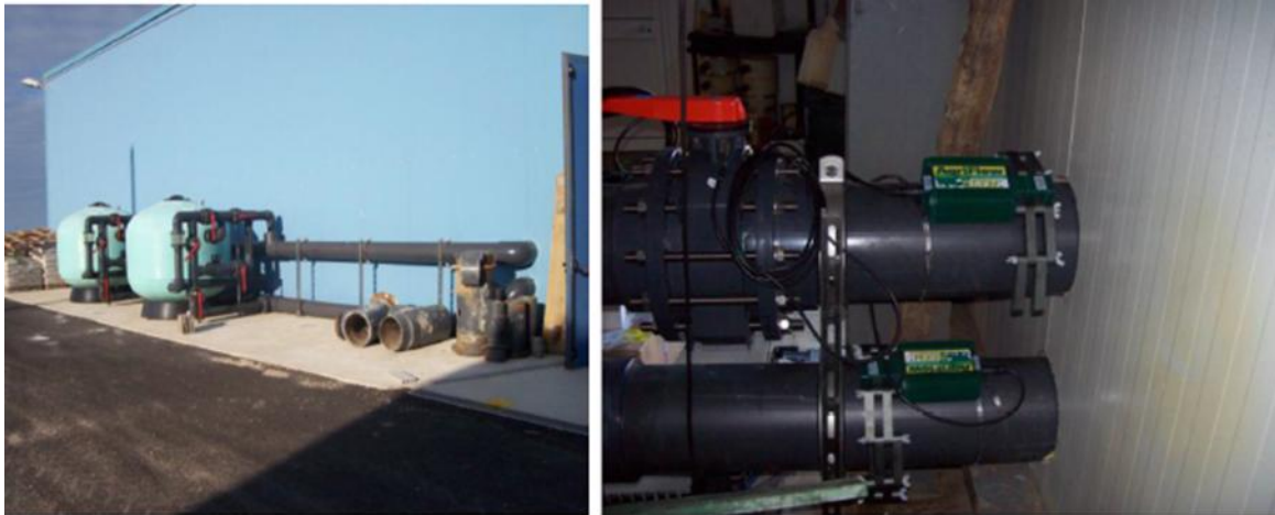
Fig. 6: HYDROPATH hydroflow I 300 installato sulle tubazioni DN 300 a monte e a valle dei filtri
